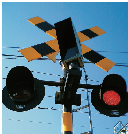
踏切警報灯〈横配置〉
