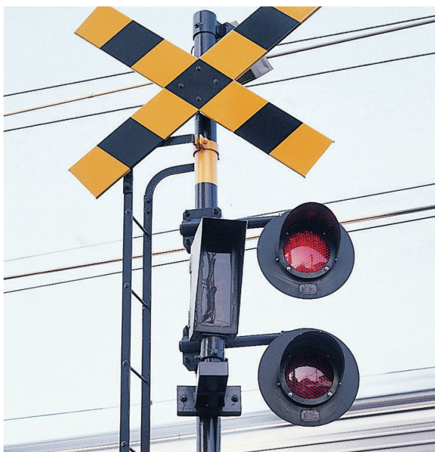
踏切警報灯〈縦配置〉
