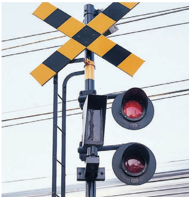
踏切警報灯〈縦配置〉
