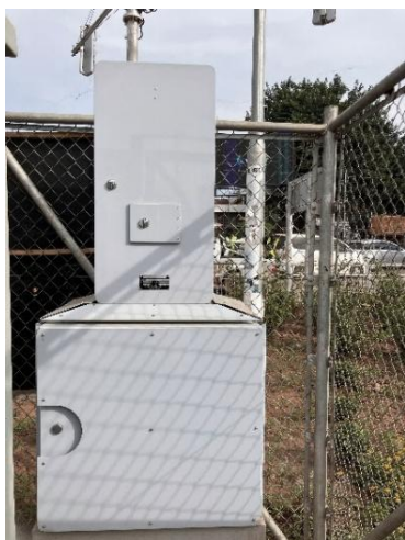
交通信号制御機・電源装置（当社納入機器）
