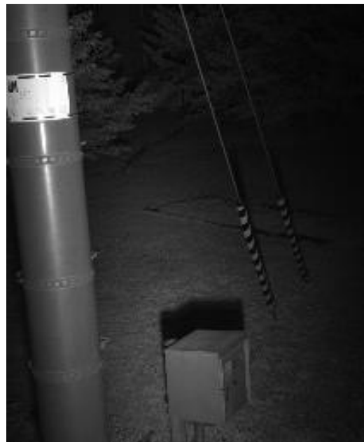
コンクリート柱
