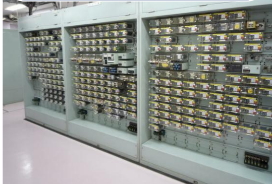
継電連動装置
