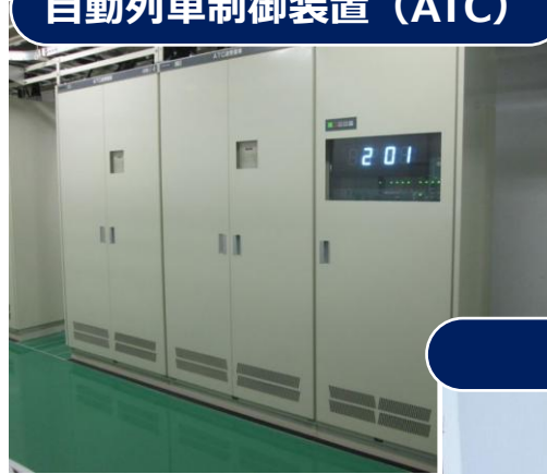
自動列車制御装置 (ATC)
