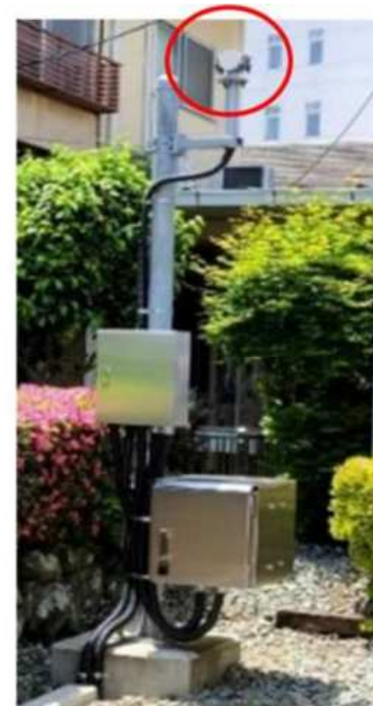
地上無線機アンテナ（赤丸部）
