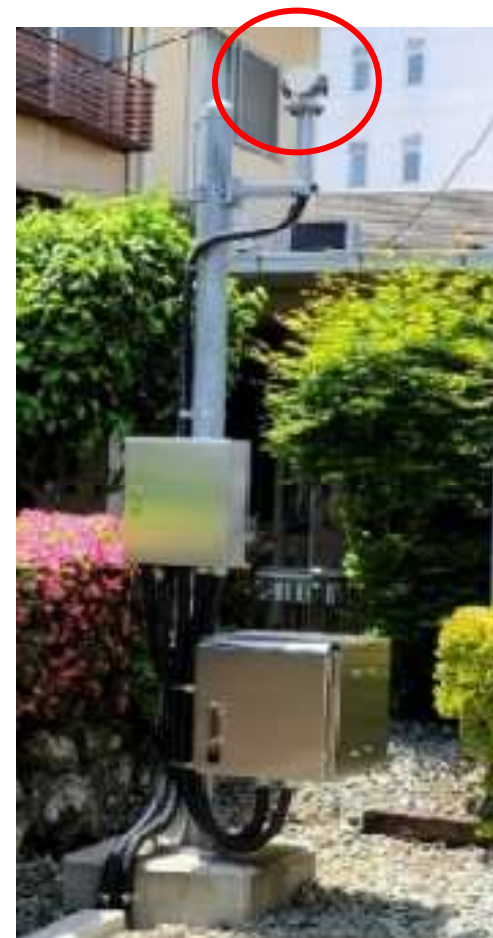
地上無線機アンテナ（赤丸部）
