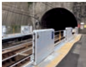
パイプ式ホームドア
