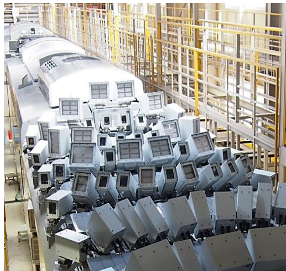
電気設備撮像装置（屋根上カメラ）
