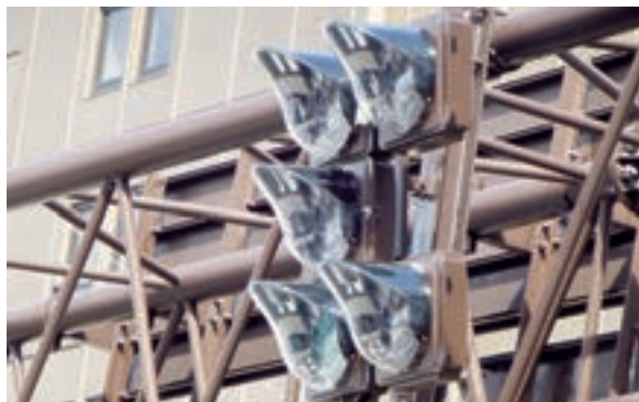
防雪カバー付交通信号灯器
